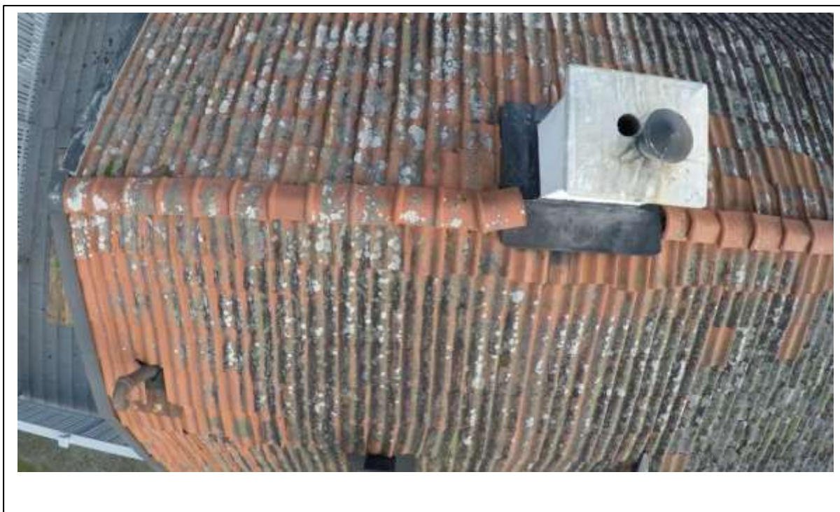
Figur 1, skyddshuv ovan genomföringar i skorsten saknas. Tegelpannor ej placerade på anvisade platser.
